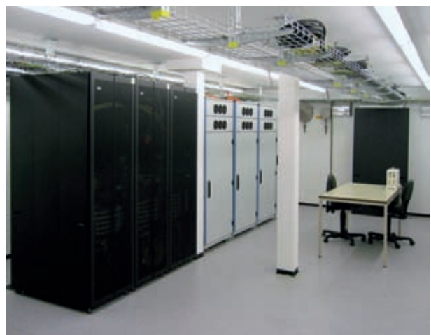
Abb. 4: Erste EDV-Anlagen des SMV stehen bereits in dem VTR-B (Provisorium). Für diese Übergangslösung wurde in Wilhelmshaven der alte Luftschutzbunker (Seezeichenschaltstelle) an der Verkehrszentrale umgebaut und saniert.
