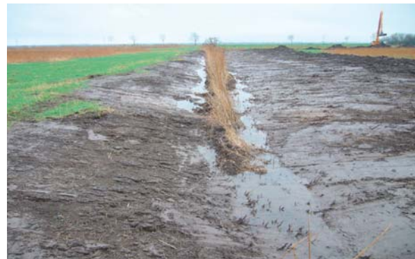
Bild 7: Grabenaufweitung vor Stauwehr in Grotegaste
