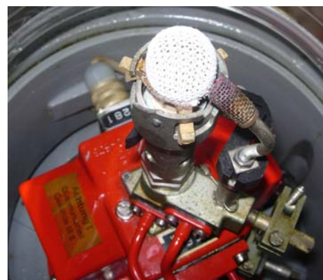
Abb. 2: Gasbrenner einer Gaslaterne
