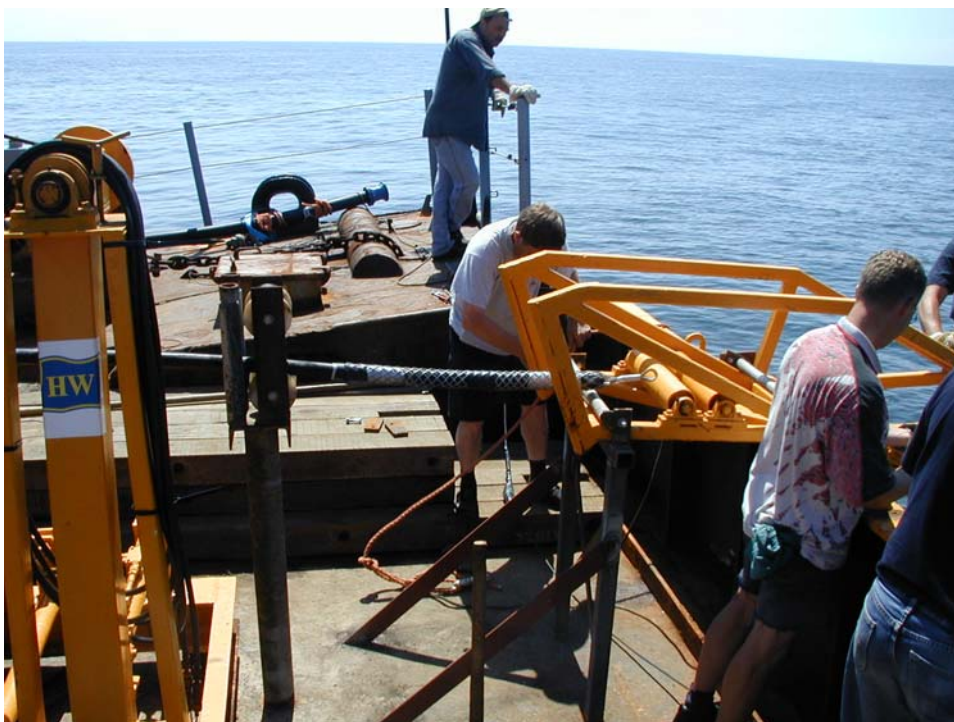
Abb. 9: Beginn der Seekabelverlegung. Das Zugseil wird mit dem Ziehstrumpf des Seekabels verbunden und über die Rollenführung außer Bord gegeben
