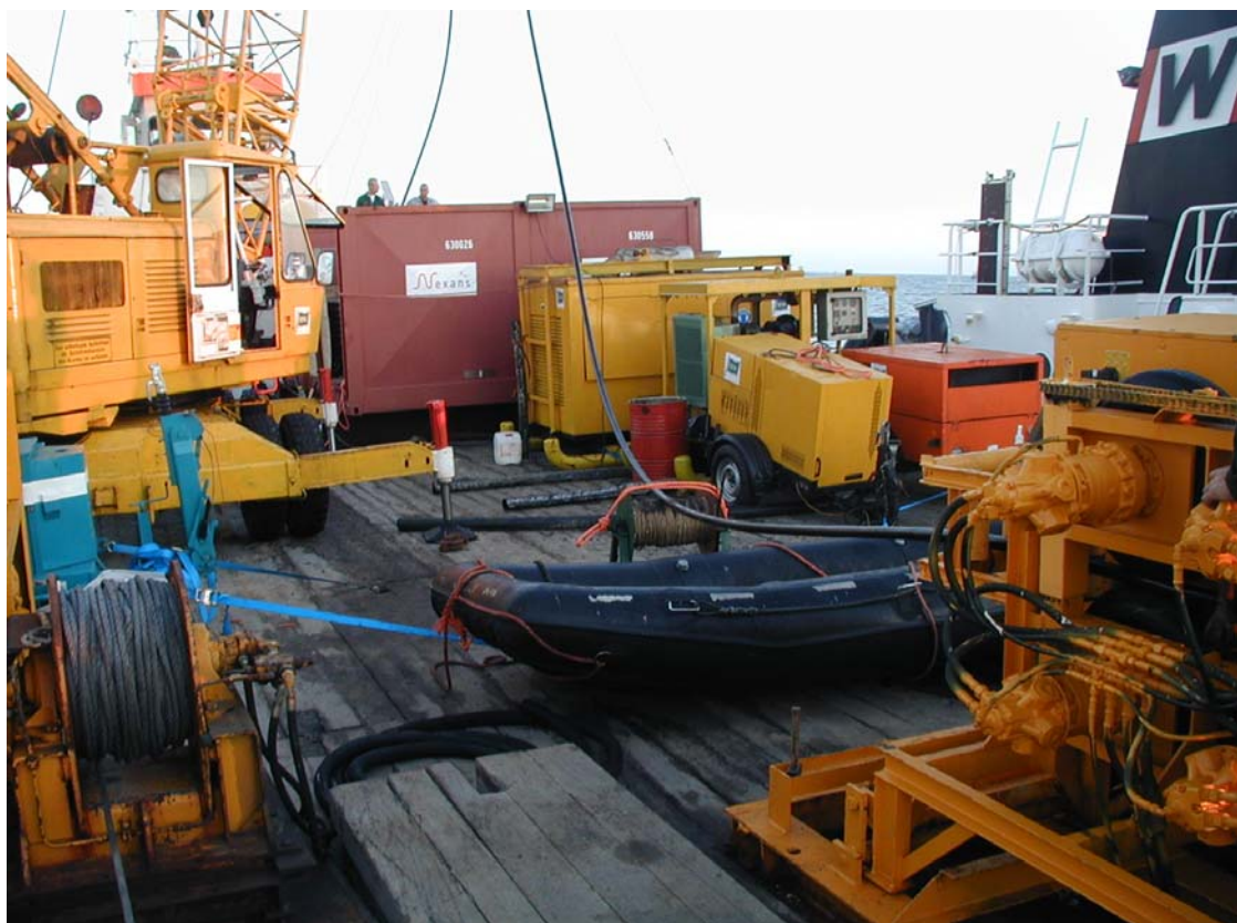
Abb. 12: Das Seekabel läuft aus dem Kabeltank über die im Bild sichtbare Rollenführung (s. Abb. 8) durch den Kabelhund (rechts im Bild)
