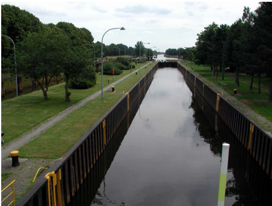
Abb. 3: Die Schleusenanlage Dütthe. Links vom Mitteldamm die alte Schleuse mit geböschter Kammer
