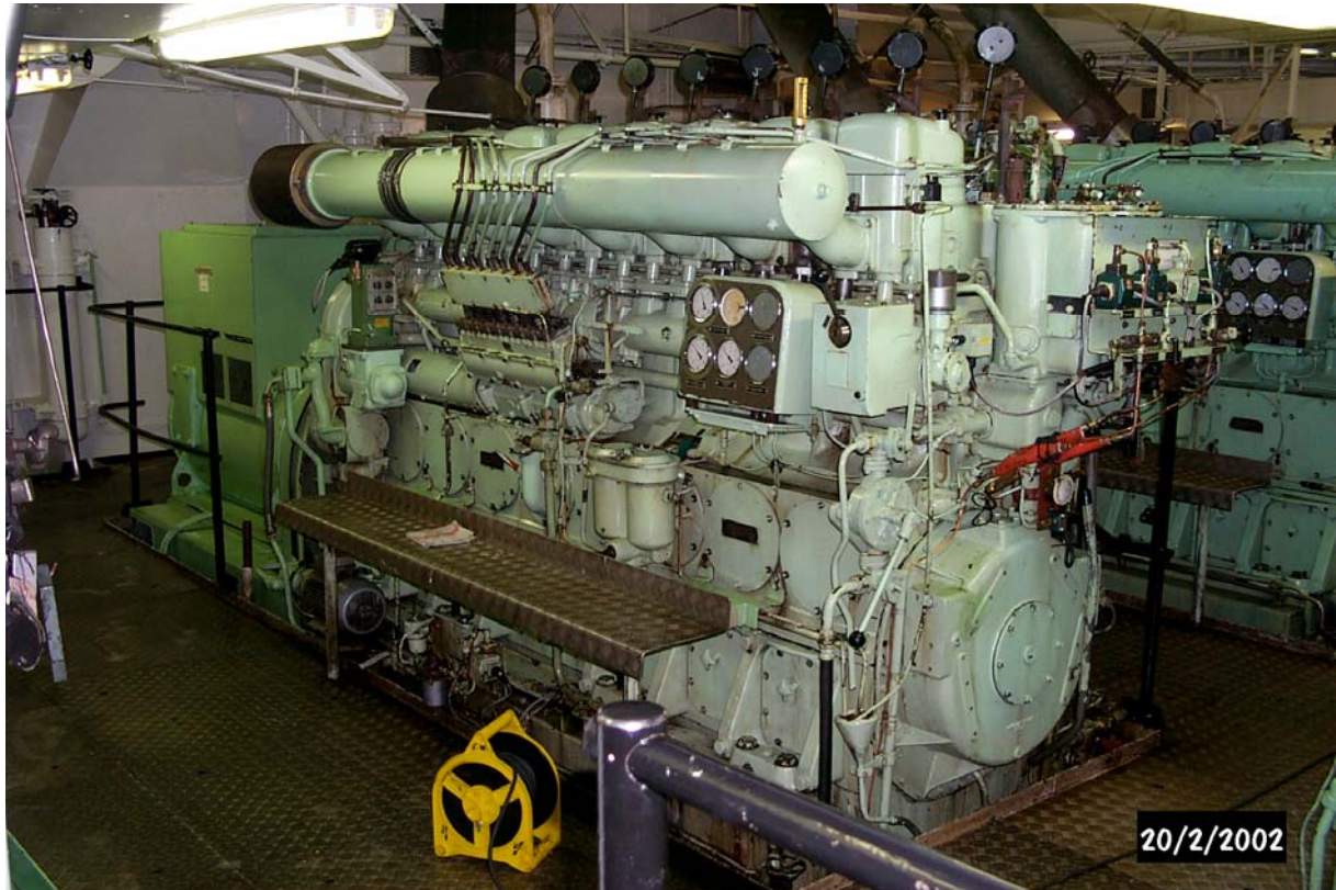
Abb. 2: Backbordaggregat der 3 alten Hilfsdiesel MWM D 440-8 auf SB "Nordsee" – sie waren 25 Jahre im Einsatz
