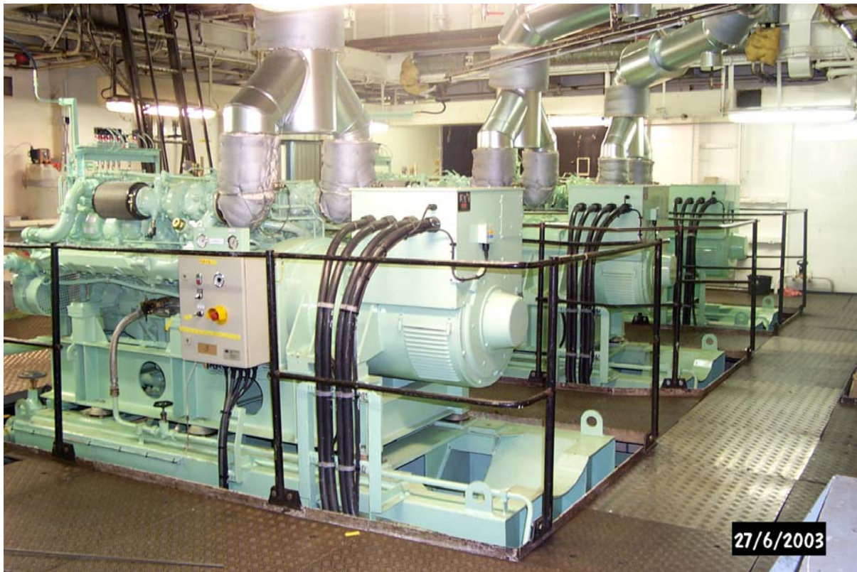
Abb. 4: Neue Dieselgeneratorsätze der Firma MAN – Typ D 2840 LE 301 – 443 kW bei 1.500 U/min.
