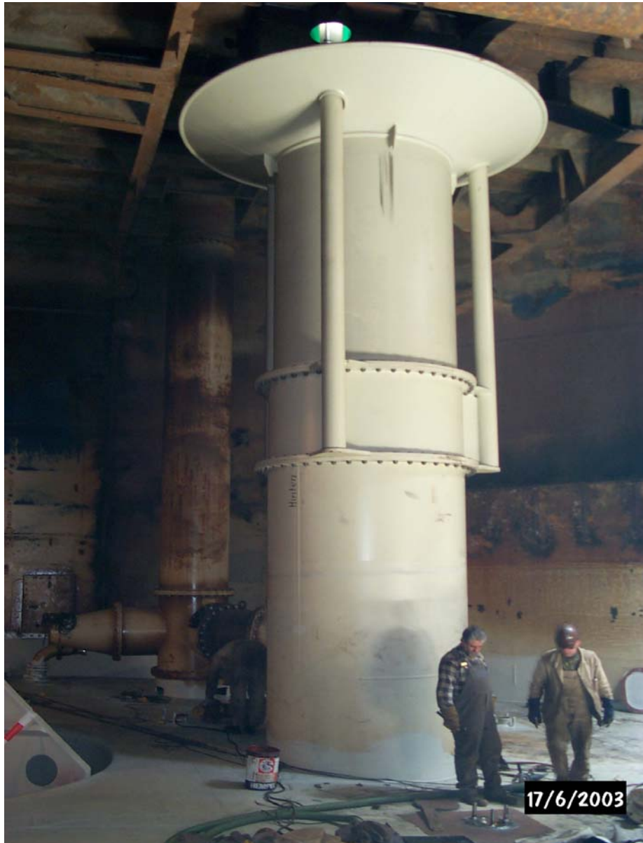
Abb. 5: Hinteres neue Trichterwehr – geliefert von der Firma IHC Holland – eingebaut von HDW-Nobiskrug
