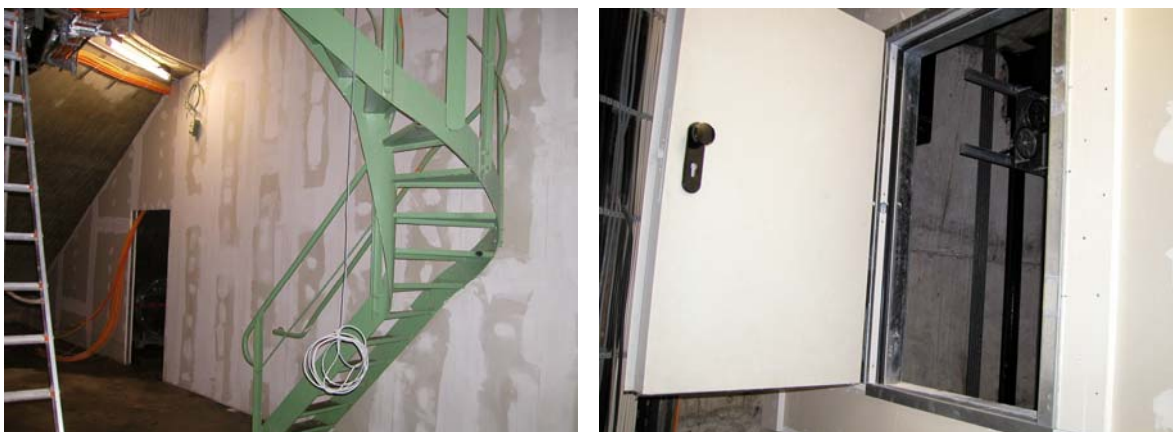
Abb. 2: Blick in den Turmschacht (oben) Detailansicht der Trennwand im Turmsockel (unten links) und der Fluchttür 60/100 cm zwischen Aufzugsschacht und Trepenschacht (unten rechts).
